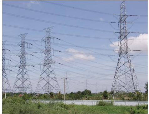
เสาไฟฟ้า
